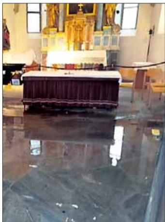
Der Kirchenraum der Jakobskirche stand unter Wasser. FFW Rabland
