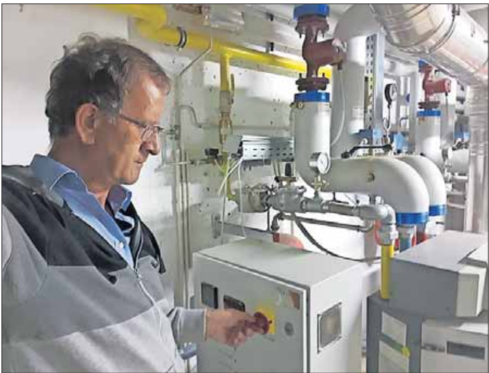
Die Heizanlage der Grundschule in Marling arbeitet schon seit 6 Jahren wasserstoffunterstützt. Mit ihrer damaligen Entscheidung war die Gemeinde Marling eine Vorreiterin im Umweltbereich. Im Bild: Bürgermeister Walter Mairhofer bei der Heizanlage.
