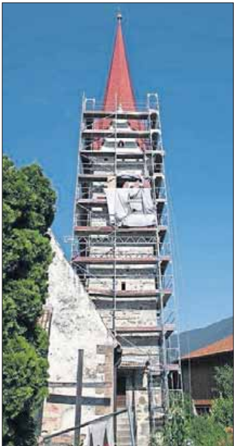
Vor fast 40 Jahren wurde der Kirchturm zuletzt saniert. privat
